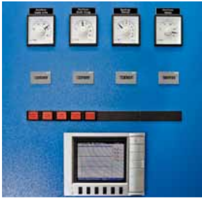
Steuerung und Registrierung Sammelbrunnenstube
