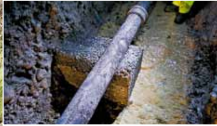
Quellableitung im Stollen
